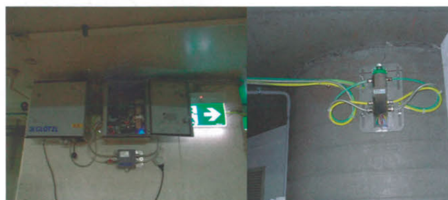
Bild 4: Schlauchwaagensensor, installiert in der Tiefgarage in der Margaret Street
